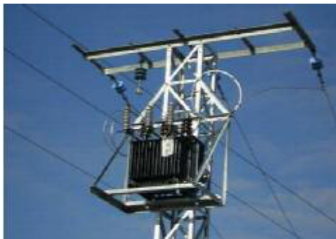
Fig. 3.29 Transformador intermedia 20 kV/230-400 V
