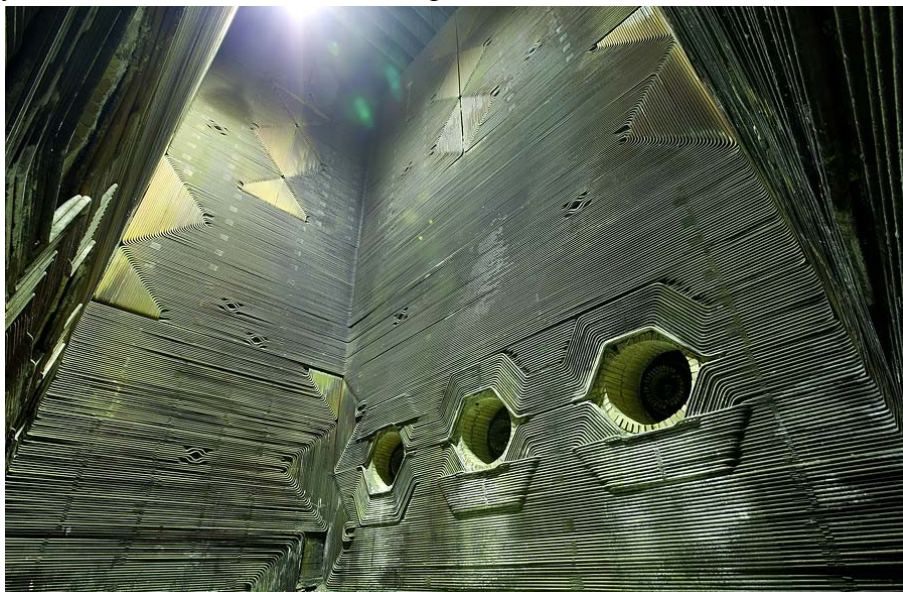
Рис. 1.3 Топка енергетичного котла ТГМП Костромської ГРЕС
