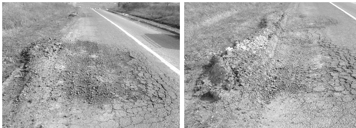
Рис. 2. Разрушение покрытия дорожной одежды в выемке на ПК 743+00 — ПК 745+00
