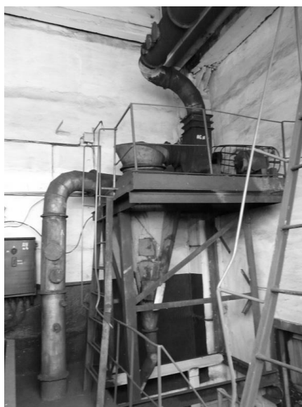
Рисунок 1 – Циклон СИОТ №5 в системе аспирации ленточных конвейеров на участке транспортирования угля Молдавской ГРЭС
