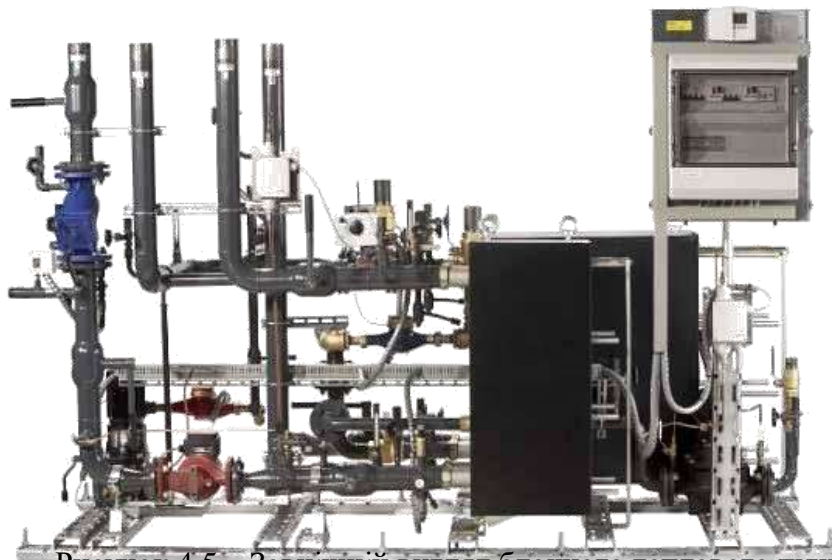
Рисунок 4.5 – Зовнішній вигляд блочного теплового пункту
