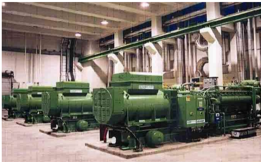
Рисунок 4.3 – Зовнішній вигляд обладнання міні-ТЕЦ з газопоршневими двигунами
