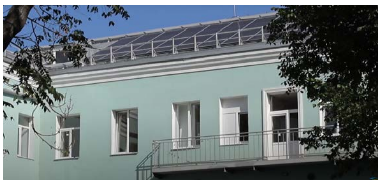
Рис. 1. Сонячні установки на даху міської лікарні №5 на бульварі Гетьмана Сагайдачного
