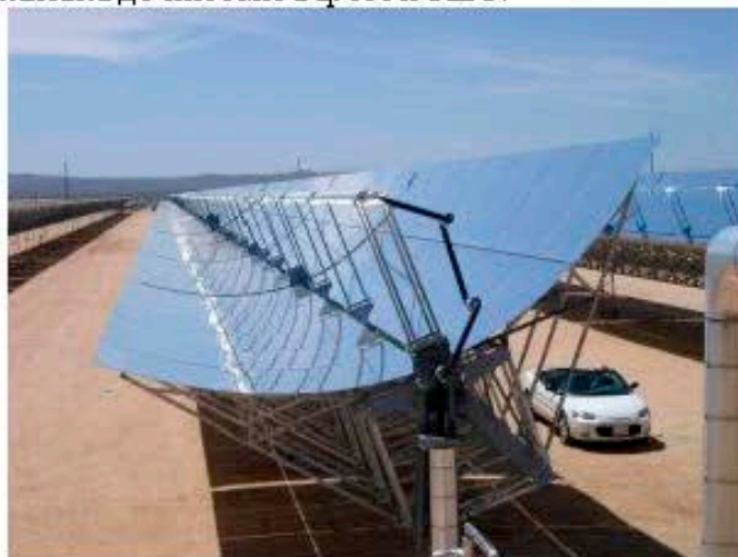
Рис. 5.1- Сонячна електростанція параболічного типу
